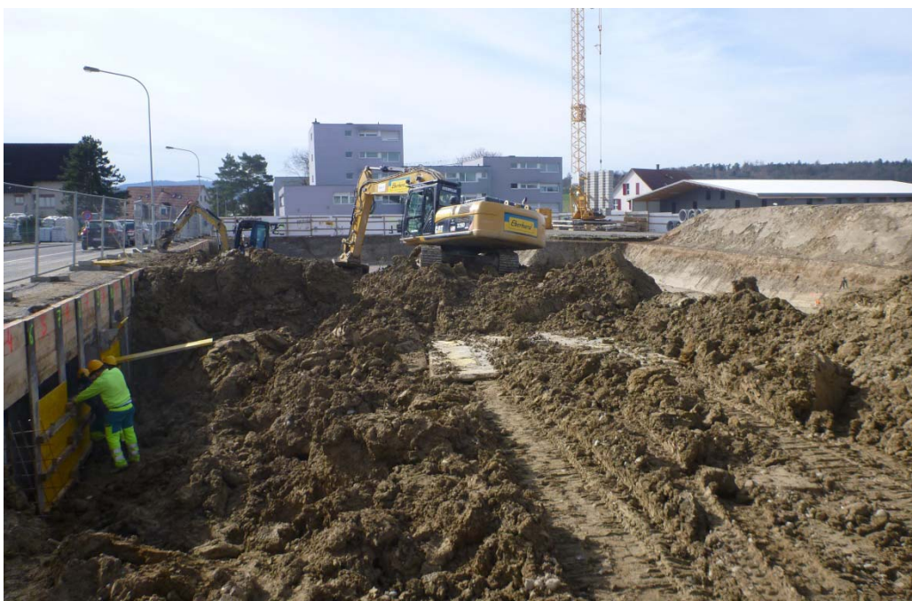
frei auskragende Rühl- wand als Baugrubenab- schluss gegen die Alt- mannsteinstrasse links
