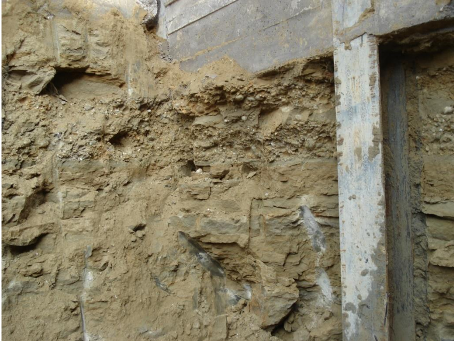
potenzielle Schwächezone aus Baugrunduntersuchung beim Aushub angetroffen
